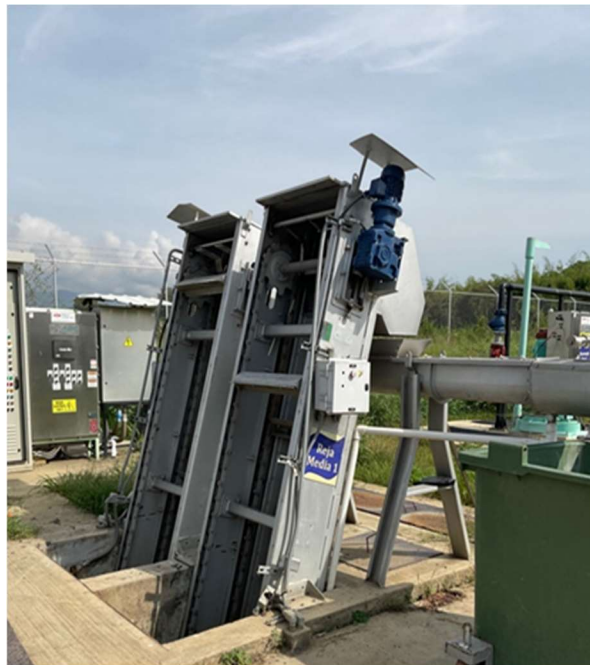
Figura 23 Rejilla de cribado gruesa. Fuente: ESPY
