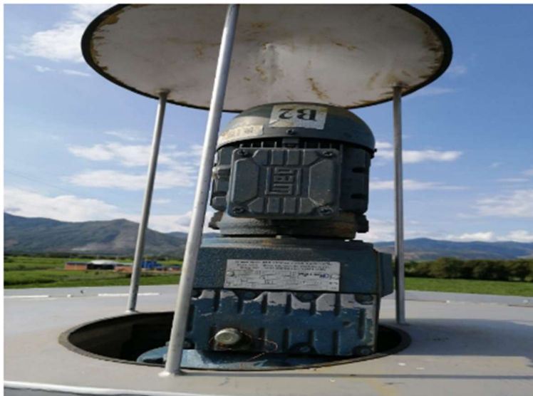
Figura 19 Motor del Percolador. Fuente: ESPY
