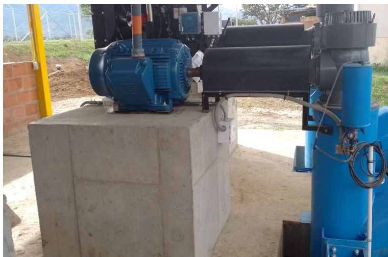
Figura 25 Bomba EBAR. Fuente: ESPY
