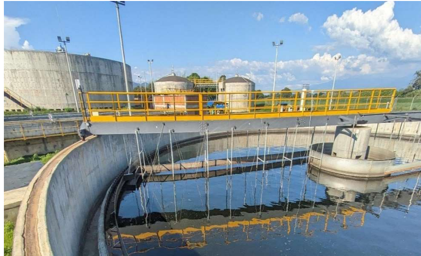
Figura 21 Motor Barredor de lodos del sedimentador. Fuente: ESPY
