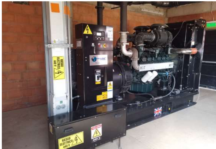
Figura 24 Grupo electrógeno. Fuente: ESPY
