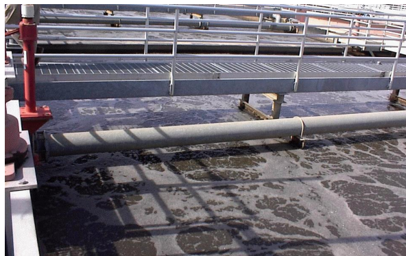
Figura 7 - Tanques de Aeración
