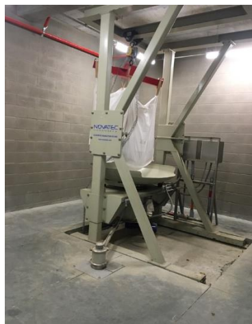
Figura 9 - Espesamiento de Lodos
