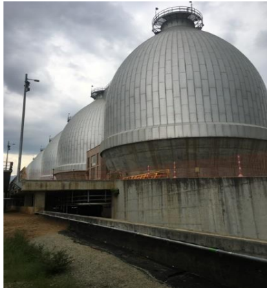
Figura 10 - Digestores de Lodos
