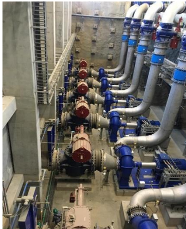
Figura 4 - Estación de Bombeo
