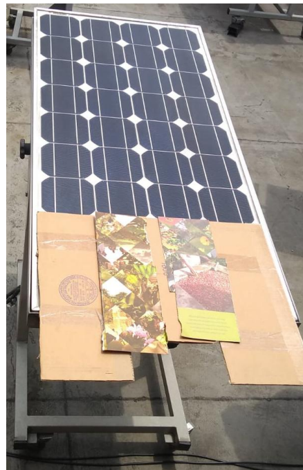
Figura 12. Panel PV con sombra en la parte inferior, la simulación se realiza con cartones.
