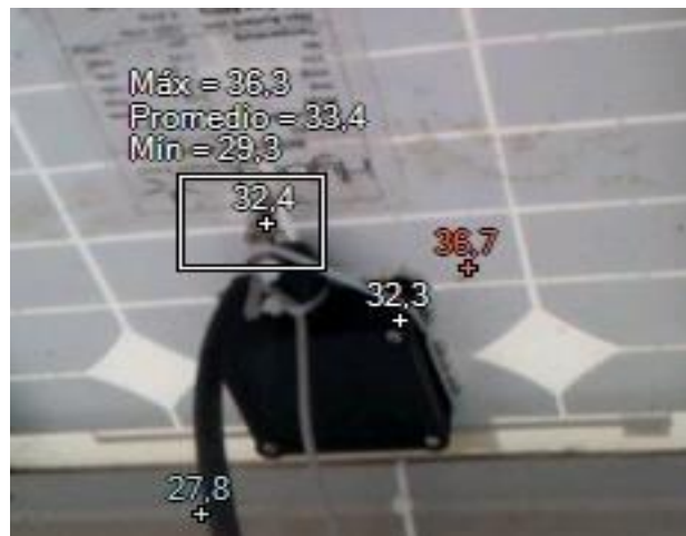
Figura 45. Imagen termográfica del sensor 7 tomado a las 11:06 am septiembre 23. Fuente: Autores.
