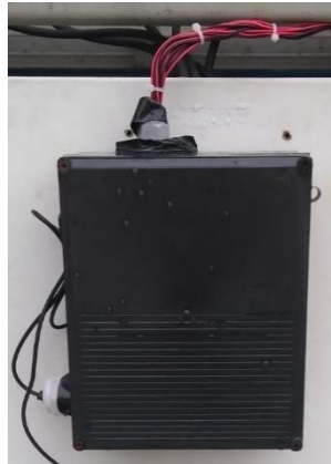
Figura 15. Caja de conexiones con cable guía de las termocuplas tipo K. Fuente: Autores
