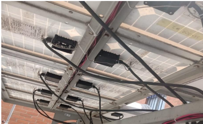
Figura 14. Instalación de los sensores. Fuente: Autores
