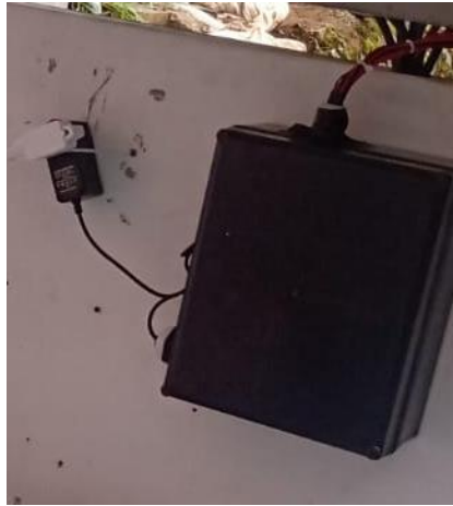
Figura 20. Caja de conexiones sellada y fuente de alimentación energizada. Fuente: Autores.
