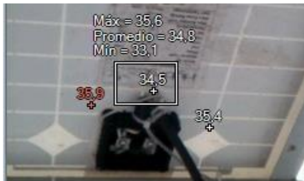
Figura 41. Imagen termográfica del sensor 3 tomado a las 11:02 am septiembre 23.
