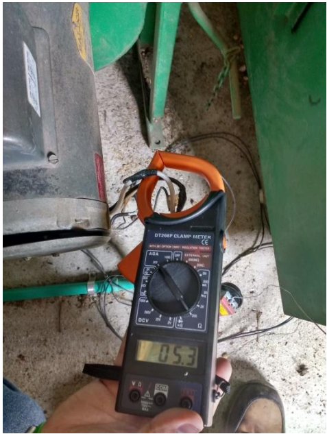
Figura 35: Foto real medición de voltaje al motor ventilador de la secadora.
