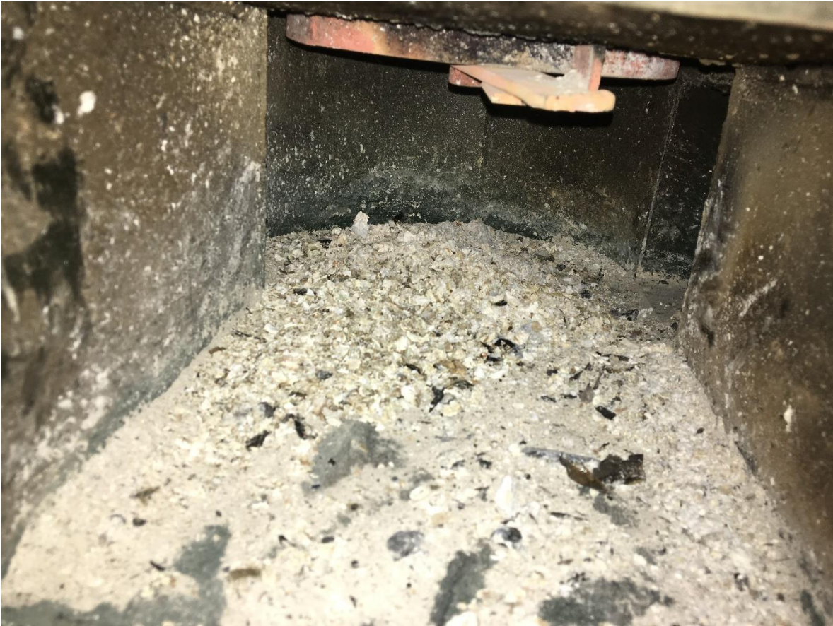
Figura 18. Foto real de parte de carga del carbón y madera del quemador parte superior.
