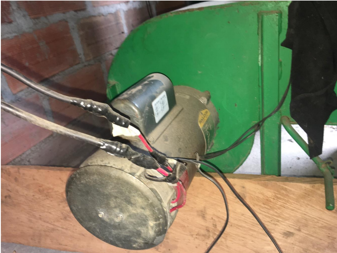
Figura 22. Foto real moto ventilador de la secadora.
