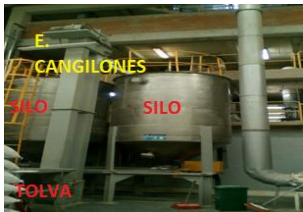
Fig. 8. Tolva de carga, elevador de cangilones y los silos. Fuente: Autor.
