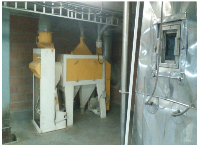
Fig. 12. Frotadora, ubicada en el tercer nivel. Fuente: Autor.
