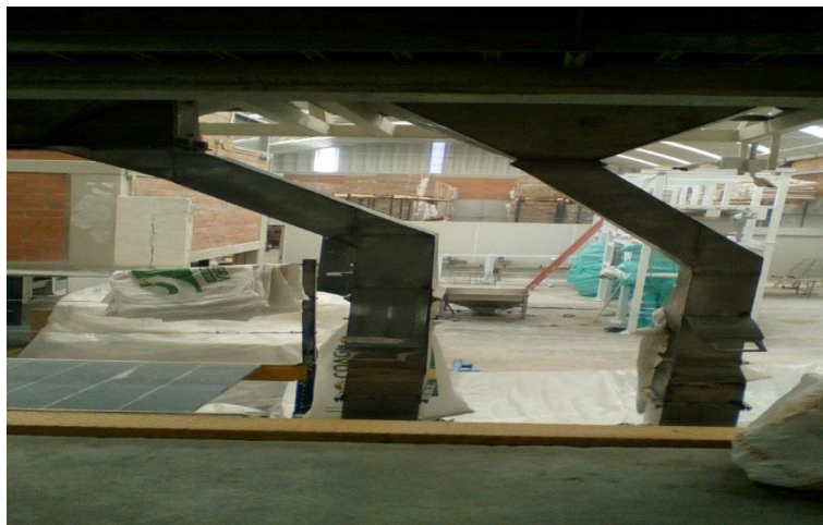
Fig. 18. Tolvas de almacenamiento de hojuela. Fuente: Autor.
