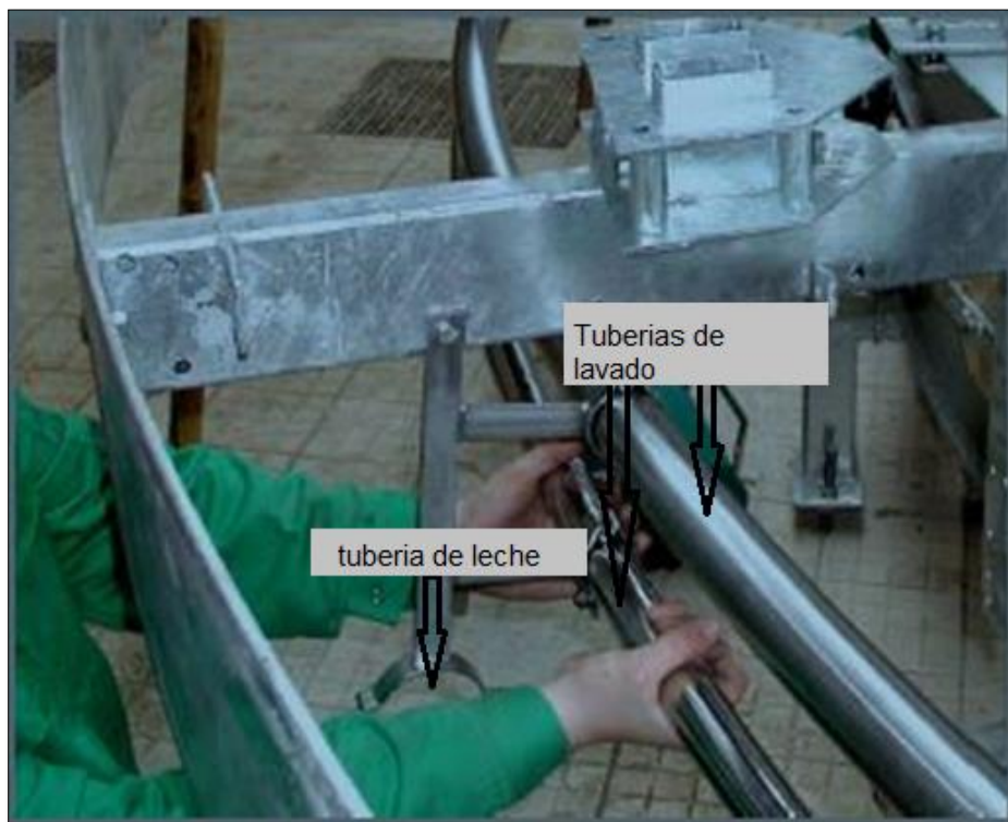
Figura 43. Tubería línea leche y lavado en sistema rotativo.
