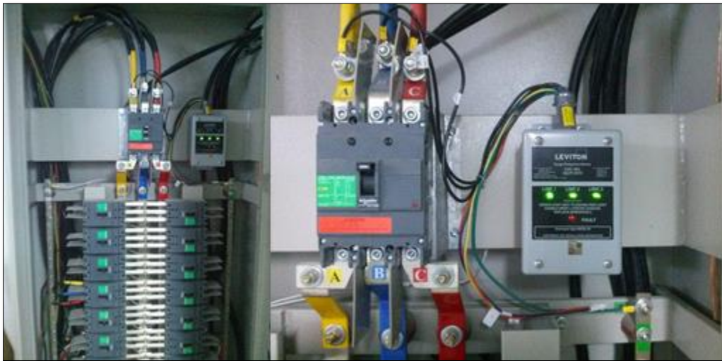
Figura 31. DPS en el gabinete principal.
