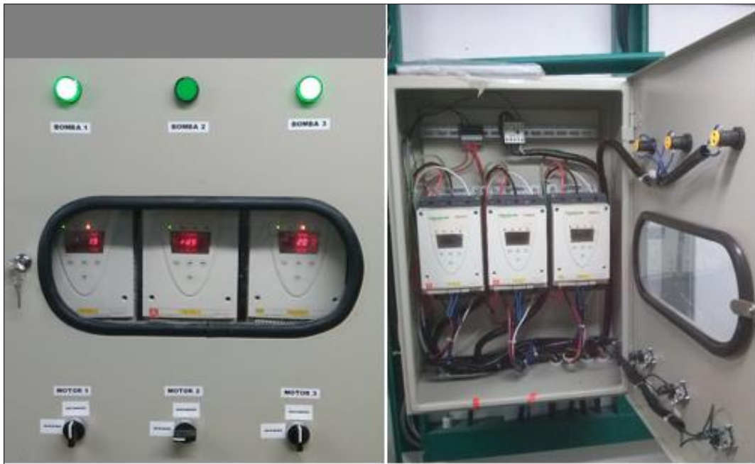
Figura 32. Gabinete de arrancadores suaves.
