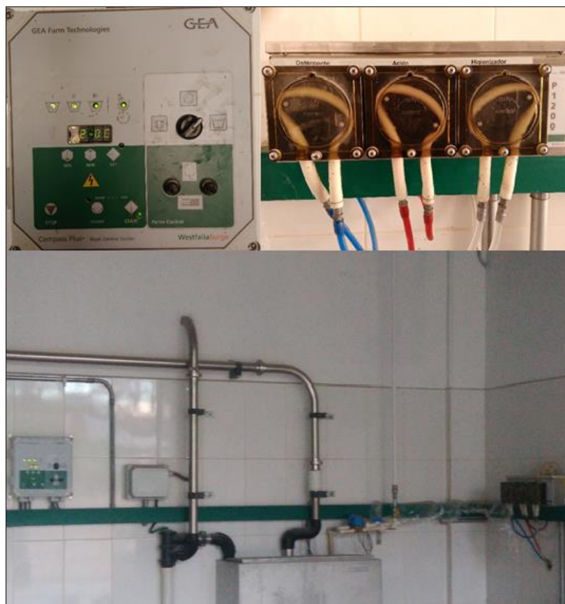
Figura 25. Componentes del sistema de lavado implementado.
