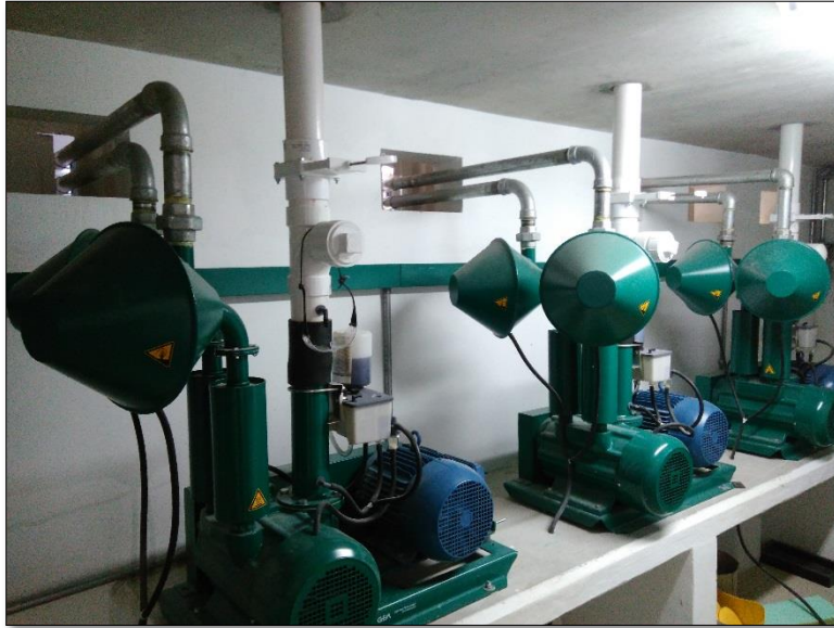
Figura 35. Bombas de vacío y motores eléctricos.
