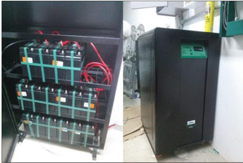
Figura 34. UPS 10KVA y Banco de baterías.
