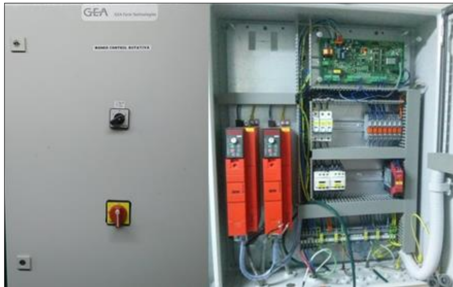
Figura 38. Gabinete de control sistema de accionamiento.
